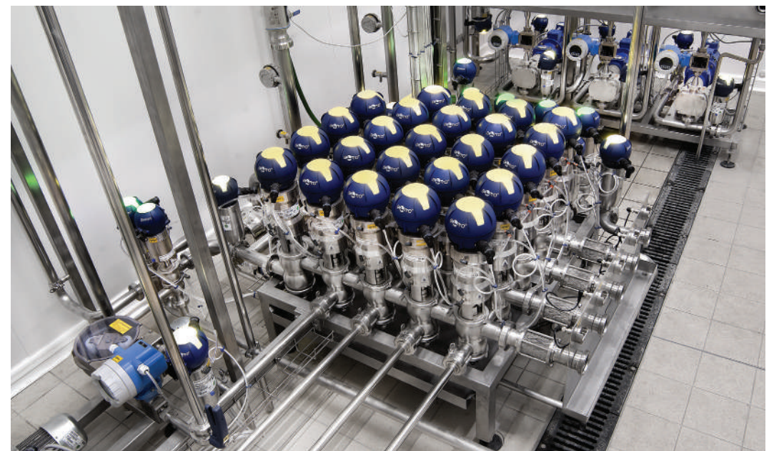
Impianti per lo stoccaggio e il dosaggio dell'uovo installati presso il pastificio Di Martino Fresh (Fava Storci).
